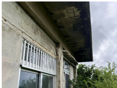
海砂使用のためコンクリート爆裂が多い住宅
